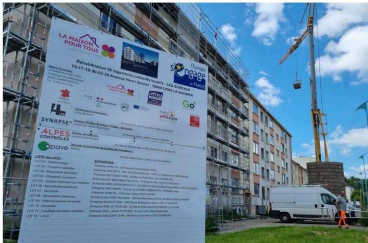
La Maison pour tous réhabilite soixante logements locatifs de l'immeuble "Les Gémeaux" avenue Henri-Grenat à Lons-le-Saunier. Photo Élodie Castelli
